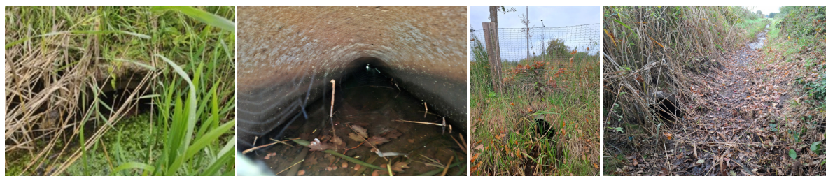
NOORDELIJKE TUNNELBUIS MANSHOLTLAAN: HALF ONDER WATER, GELEIDING EN UITGANG WESTKANT
