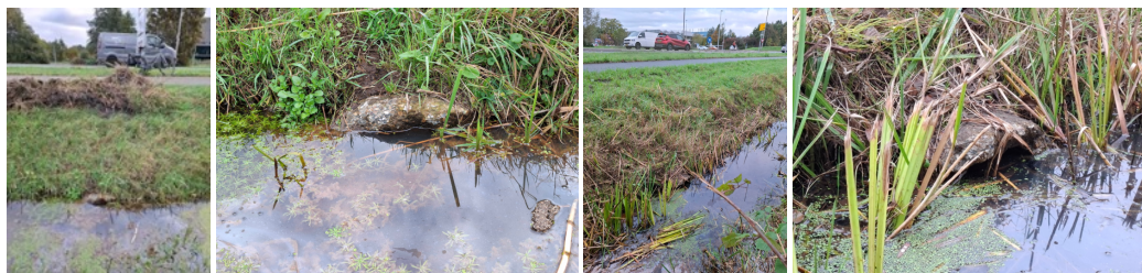
ZUIDELIJKE TUNNELBUIS MANSHOLT LAAN: ONDER WATER, GEEN GELEIDING
